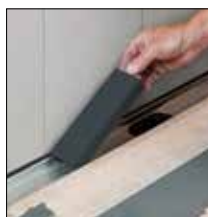
=> 2. Mettre en place le gabarit de pose dans le corps du caniveau
